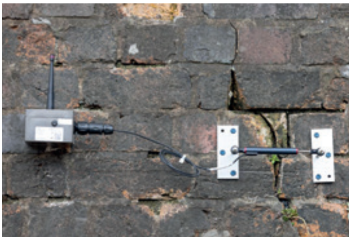
Bsp.: Einkanal Node mit Risssensor Erfassung von Dehnung und Stauchung
